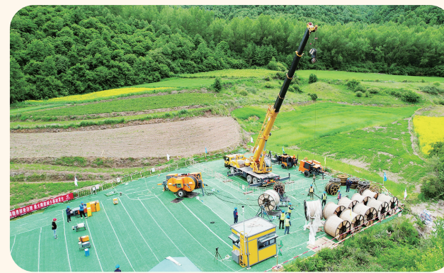
国网甘肃省电力公司在甘肃定西渭河源330千伏线路工程施工现场试点应用电动张力机。李鹏/摄
