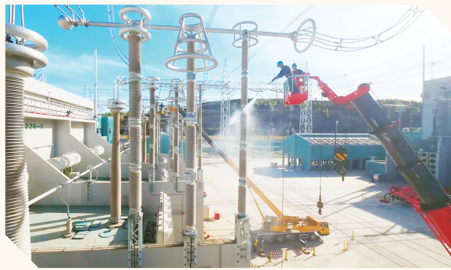
图为国网陕西电力员工进行陕北换流站年检。
