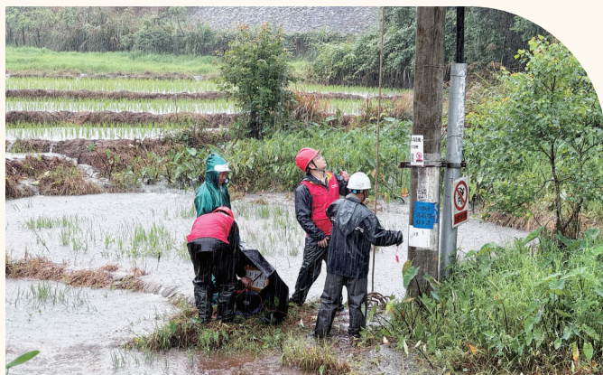
图为6月15日，福建邵武市供电公司员工在抢修和平镇10千伏乌石线001塔至027杆间A相全失地故障。郭慧超/摄
