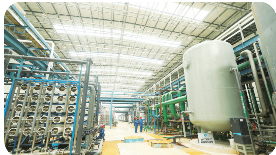
中煤陕西公司煤化工厂区公用工程矿井水装置综合车间
