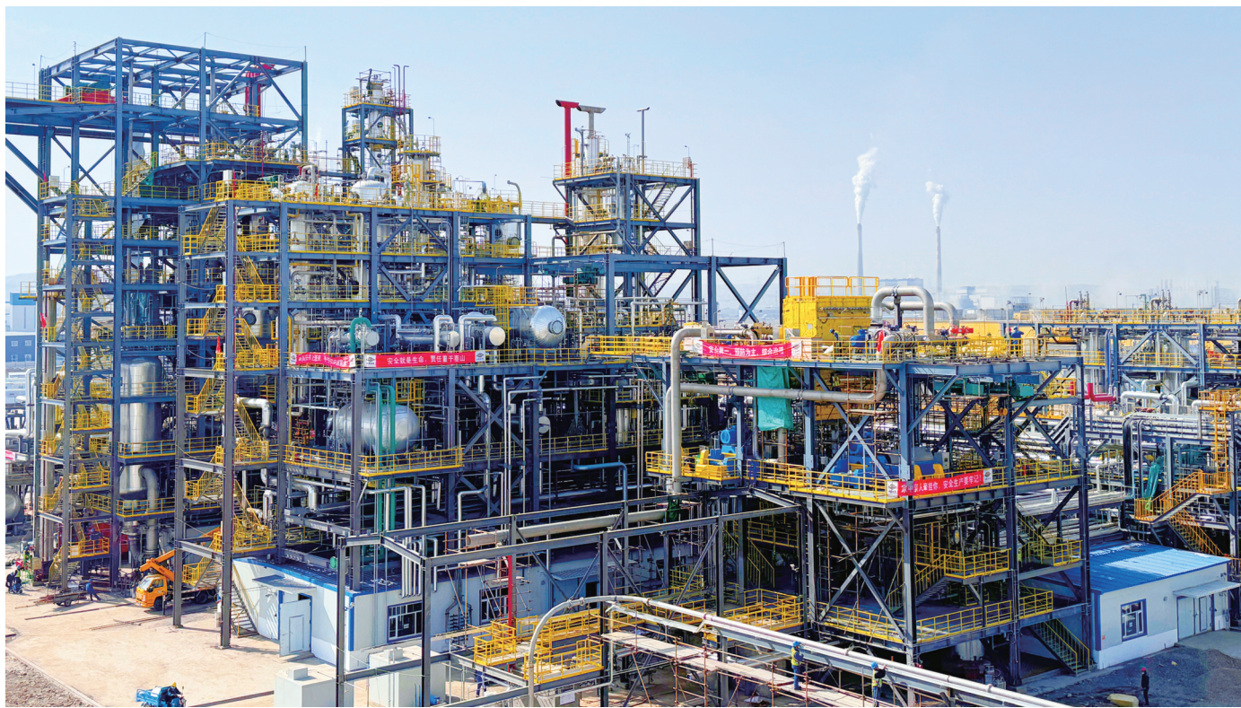
图为山东能源新疆能化公司6万吨三聚氰胺项目现场。山东能源集团/供图
