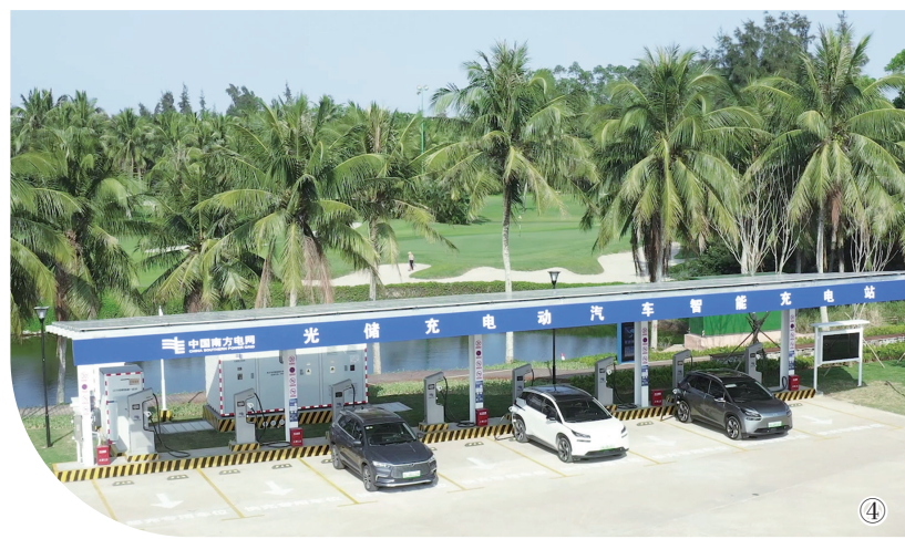
④南网储能2023年3月建成投产的海南省琼海市博鳌镇东屿岛首座光储电动汽车智能充电站。
