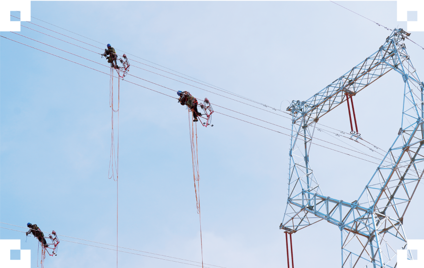
图为工作人员在兰新（张）三四线甘肃牵引站330千伏外部供电工程（兰州段）施工现场GC40到GC42安装导线间的间隔棒。
