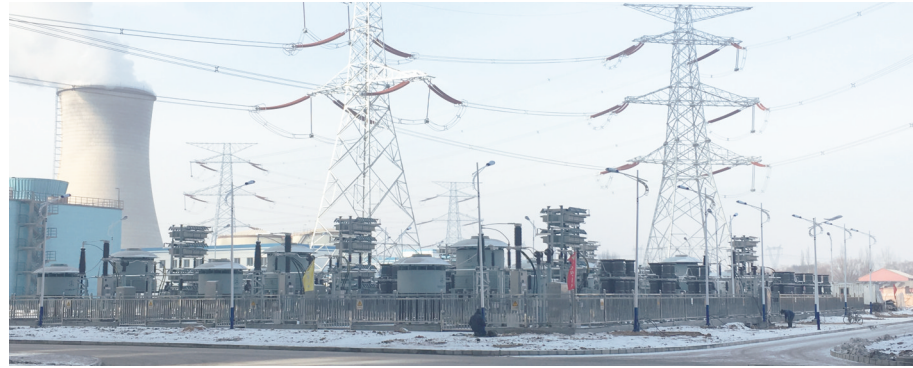
托克托电厂五期机组的阻塞滤波器外观。
