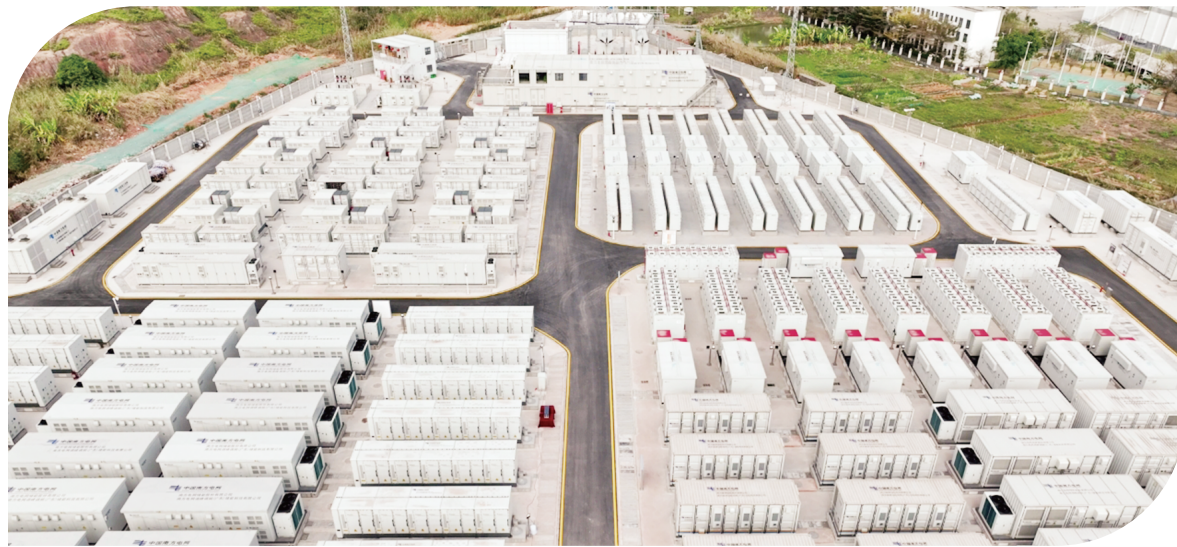
图为粤港澳大湾区规模最大储能电站——佛山宝塘储能站。南网储能公司/供图
