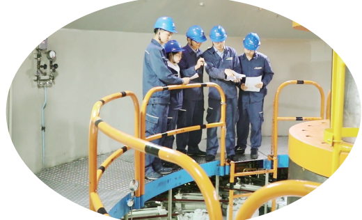
团队研发人员进行国产抽水蓄能数智调速器更新投运前的状态巡视。南网储能公司/供图
