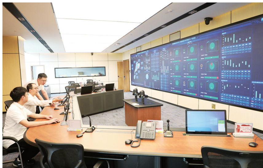
2023年4月,我国首个大规模抽水蓄能人工智能数据分析平台——南方电网抽水蓄能人工智能数据分析平台XS-1000D投入运行。南网储能公司/供图
