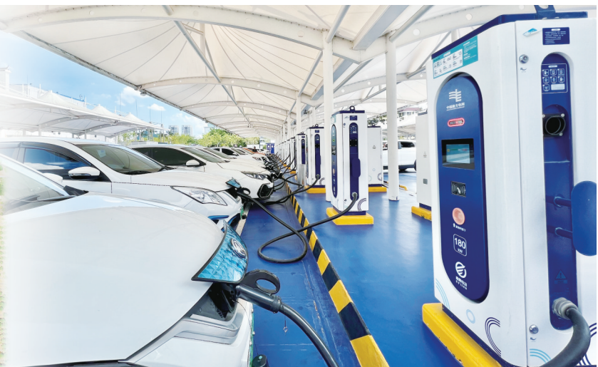
南方电网广西柳州鹿山电动汽车综合能源充电站,让新能源车用上新能源。 廖柳伶/摄
