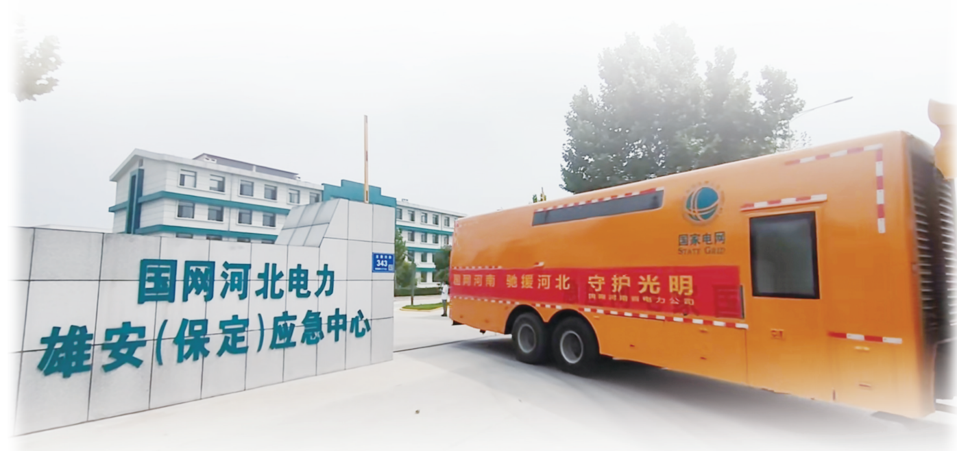
各地驰援河北的应急发电车在国网河北电力雄安（保定）应急中心集结后出发
