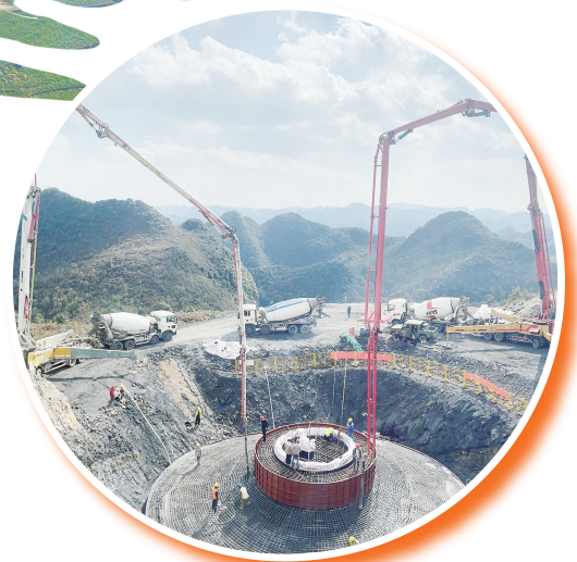
图为金沙县中寨分散式风电。 毕节市能源局/供图
