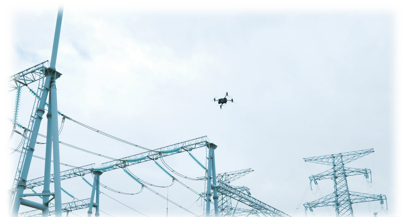
保山220千伏大寨变电站实施无人机巡检。蒋绍康/摄
