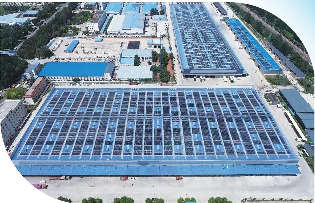
▲图为平顶山易成新材料有限公司分布式光伏发电项目。
