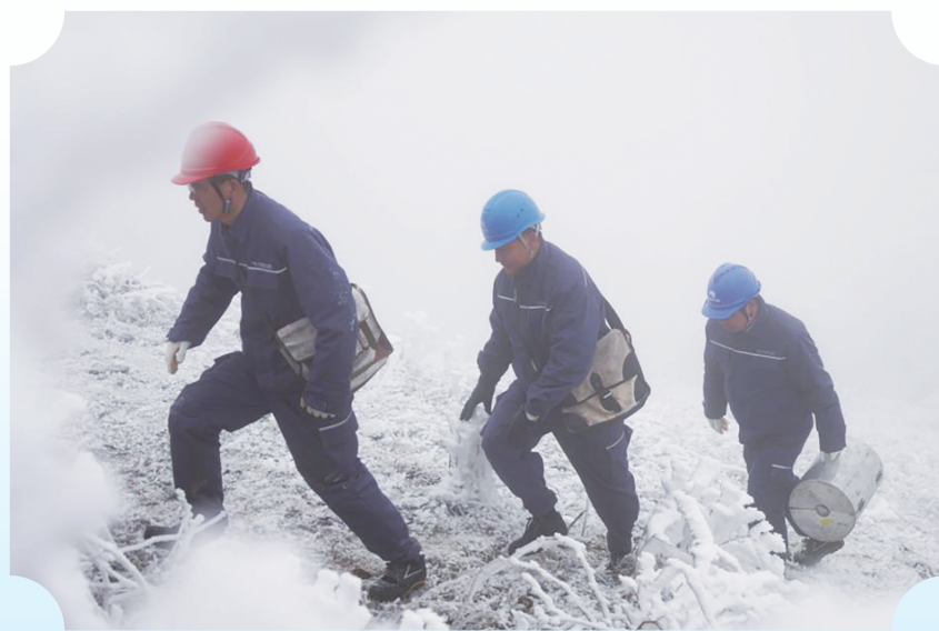
图为2月24日南网超高压公司曲靖局运维人员特巡所辖牛从乙牛侧接地极线210号塔途中。 戴永平/摄
