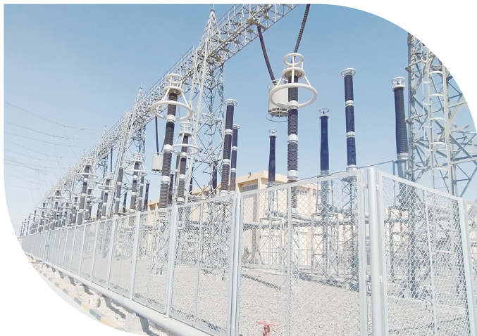
位于中埃泰达苏伊士经贸合作区的埃克萨迪亚500千伏变电站。
