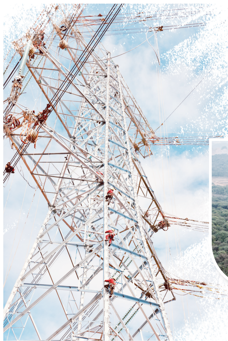
日前,在500千伏绍诸、绍暨输电线路重大迁改工程现场,工作人员利用难得的晴好天气加紧开展5G号塔架施工。
