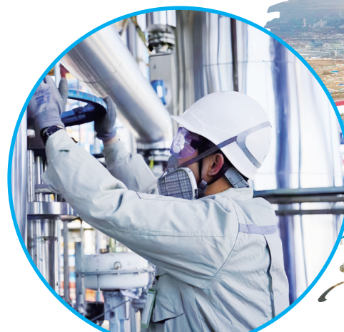
10万吨年颗粒硅项目运营期工人检修机器。建设银行内蒙古区分行/供图
