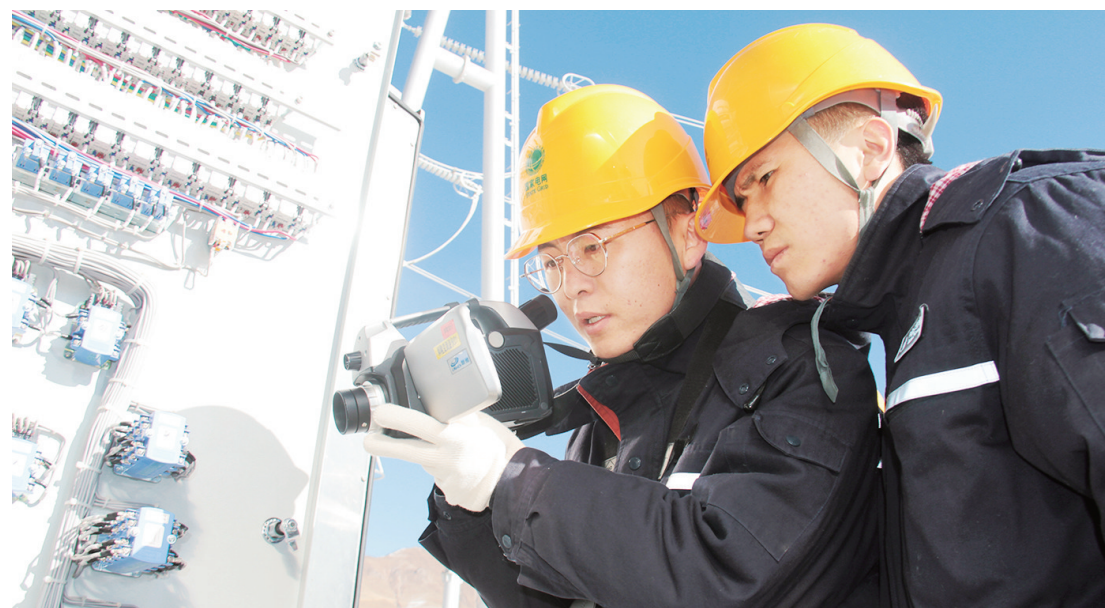
图为国网青海电力员工迎峰度冬期间在750千伏郭隆变电站开展安全巡视。马清/摄
