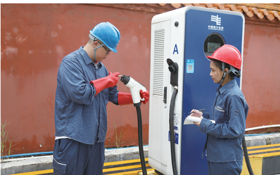
图为南方电网海南电网公司工作人员对充电桩进行运维检查。卢欣/摄
