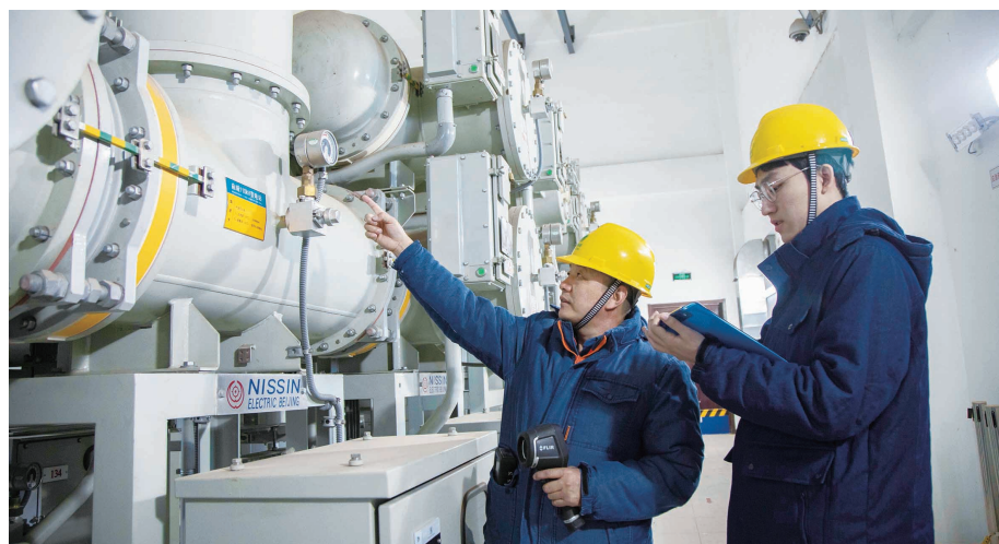
图为国网北京电力怀柔公司变电运维班员工在110千伏变电站检查设备压力值。池源/摄
