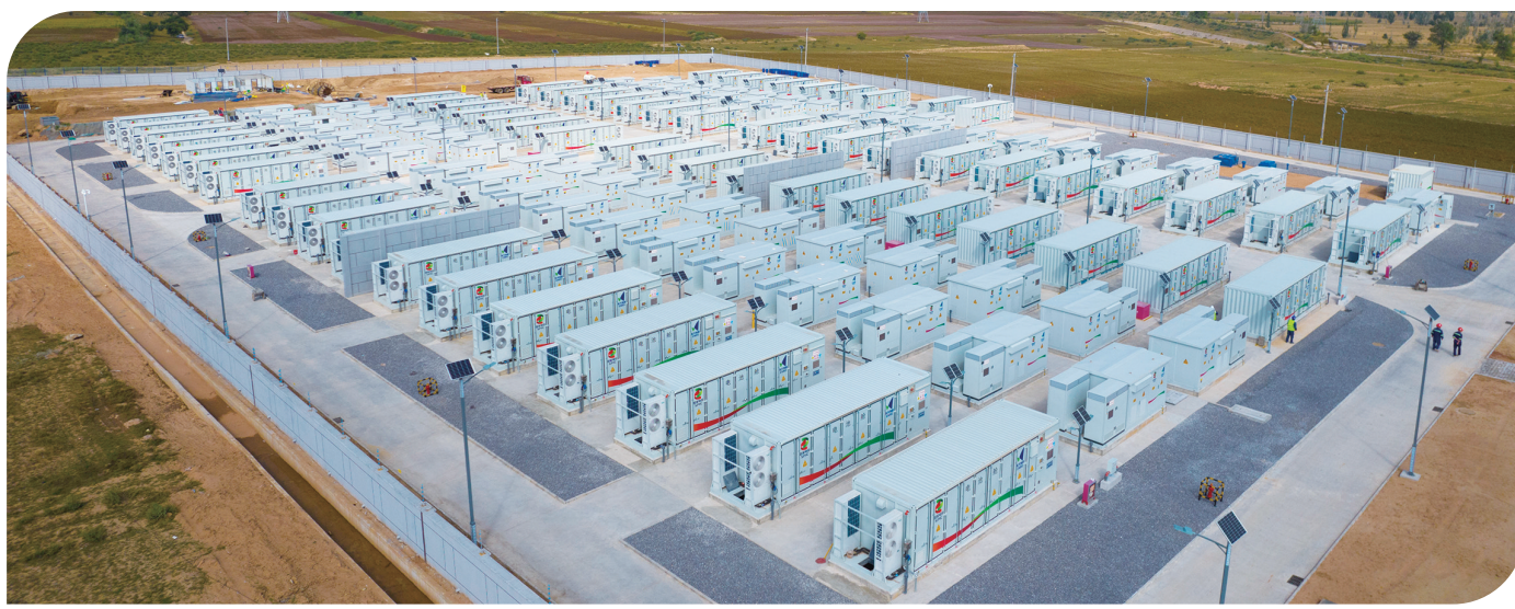
图为装机规模为200MW/400MWh的宁夏盐州变共享储能电站,海辰储能是该项目的独家电池供应商。海辰储能/供图
