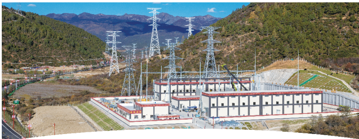
即将投运的220千伏白塔输变电工程。
