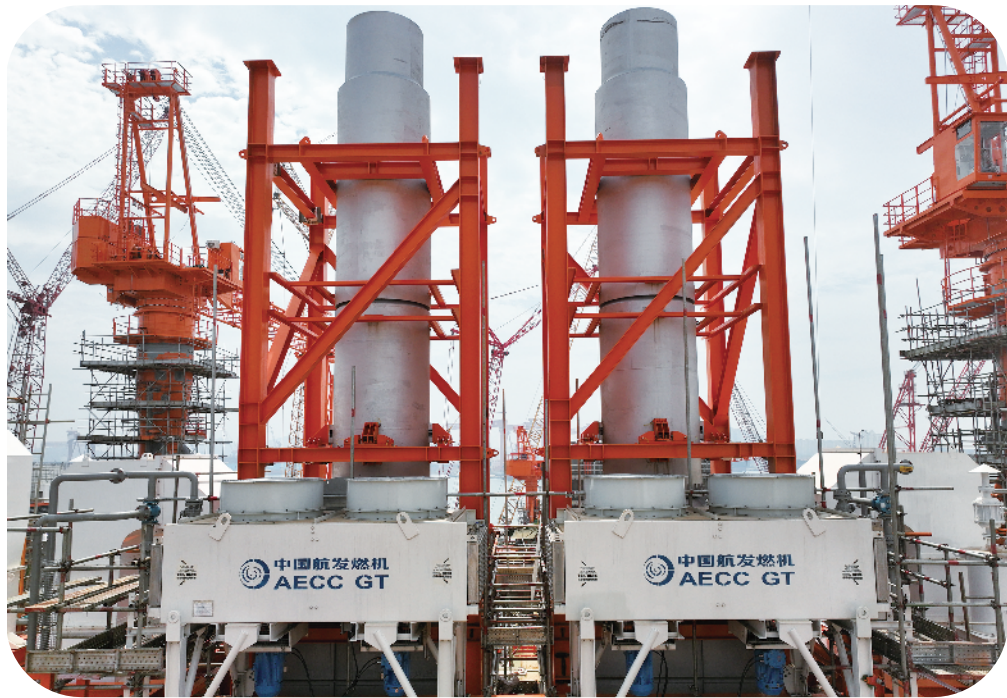
安装在陆丰8-1平台上的“太行7”燃气轮机。中国海油/供图
