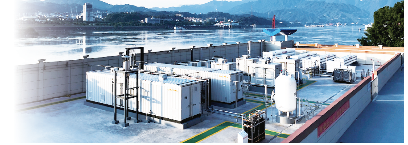
图为阳光氢能为三峡长江电力绿电制氢示范项目提供的柔性制氢系统。阳光氢能/供图
