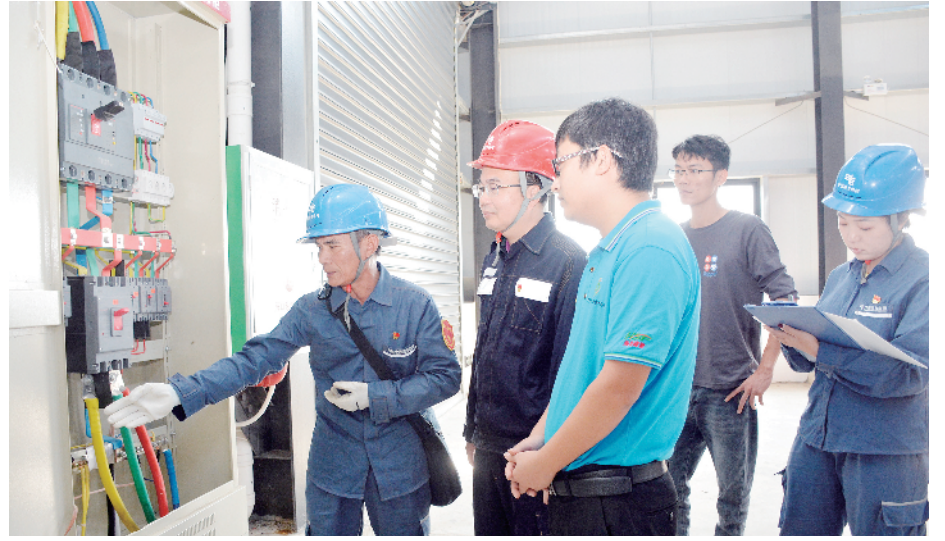
图为三亚供电局组织党员走进企业查隐患,当好“电管家”。刘昌/摄
