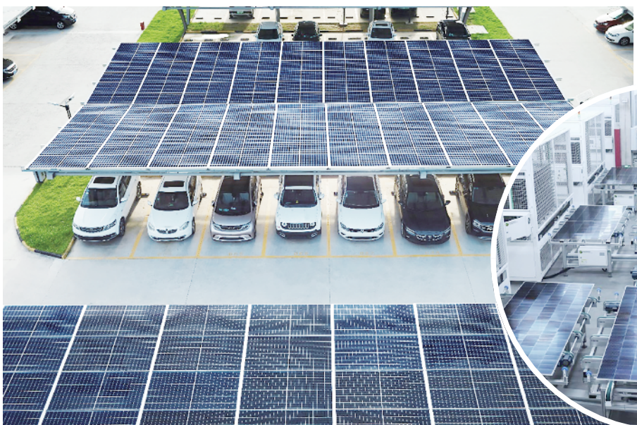
图为正泰新能盐城基地光伏停车棚。
