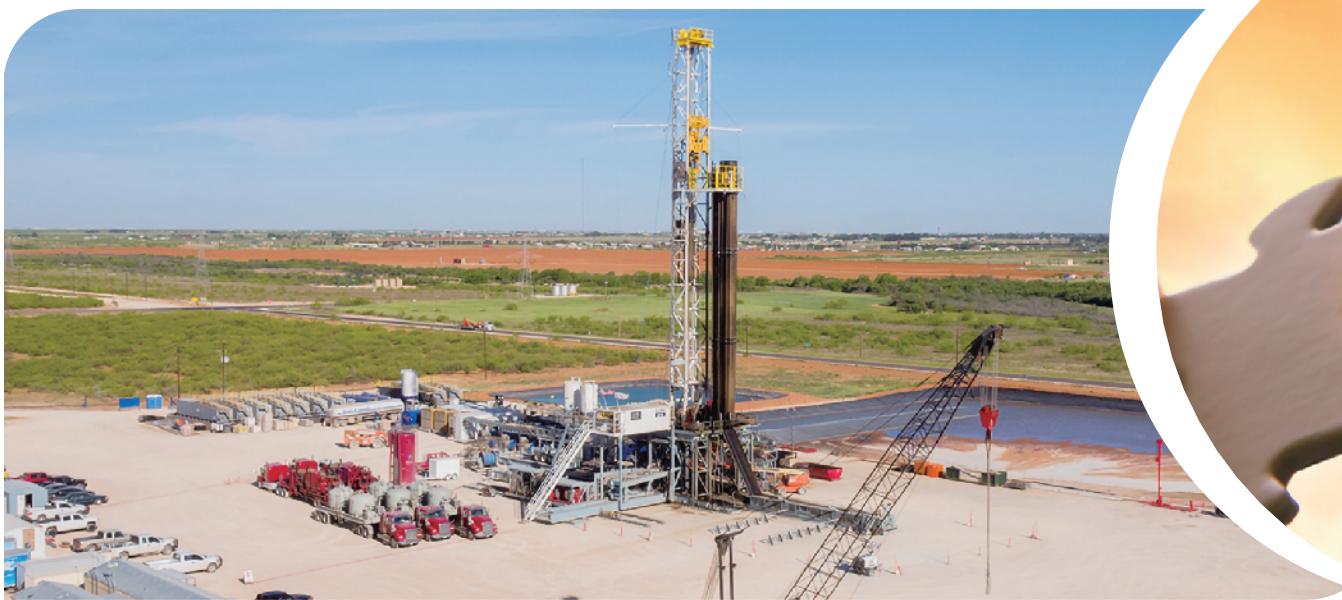
先锋自然资源公司位于二叠纪盆地的一座钻井平台。
