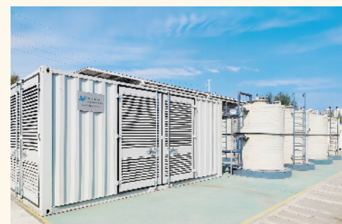
250kw/1MWh全钒液流电池光储充示范项目。承德新新钒钛储能科技有限公司/供图
