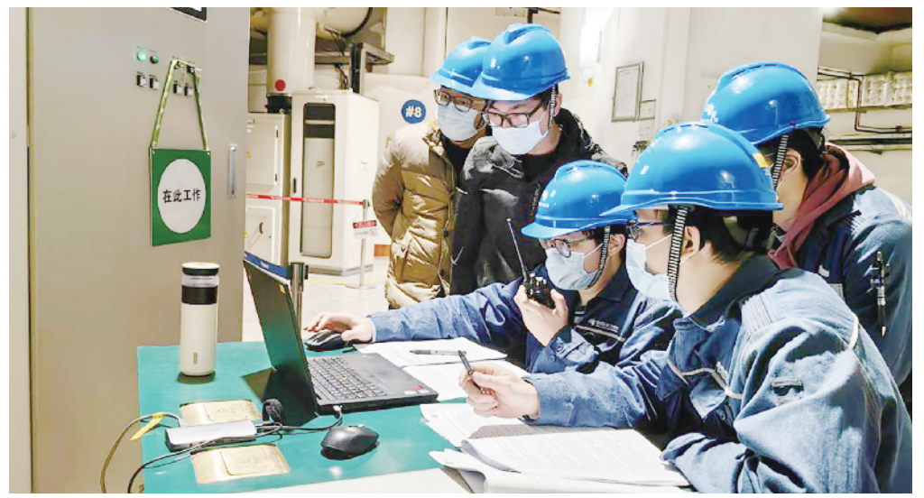
图为南网储能检修试验分公司项目组成员有序开展广蓄电站#7机组励磁系统现场动态调试工作。南网储能公司/供图
