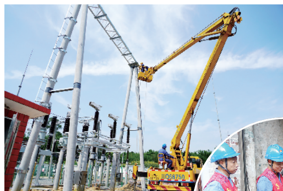
图为四川省水电集团迎峰度夏重点项目建设现场。代虎/摄
