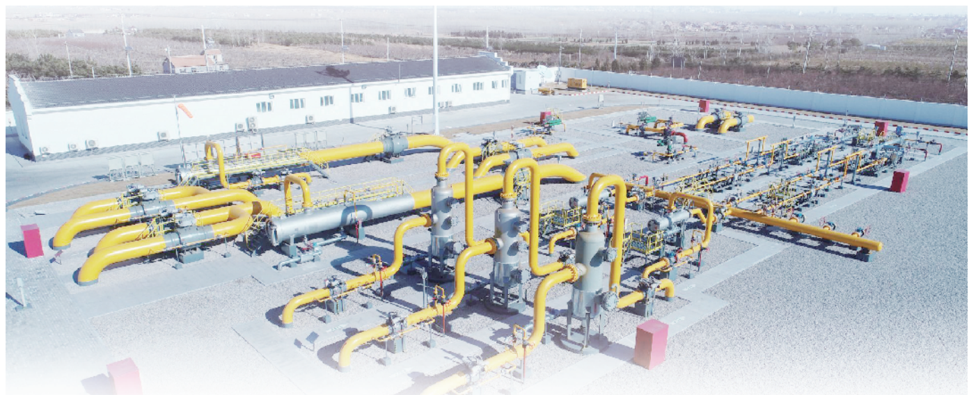
图为青宁天然气管道。资料图片
