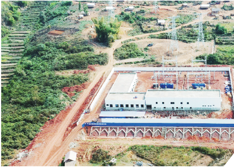
图为中老铁路老挝段外部供电项目牵引变电站。
