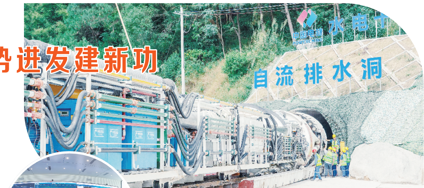
图为南网储能公司南宁抽水蓄能电站项目(TBM)硬岩隧道掘进机。
