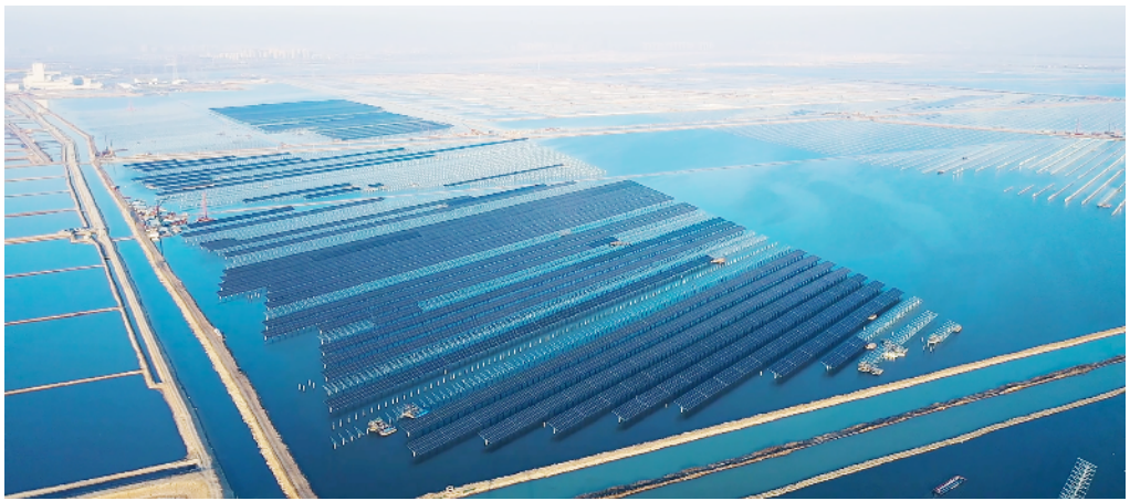
图为天津华电海晶1000MW盐光互补光伏发电项目。隆基绿能/供图
