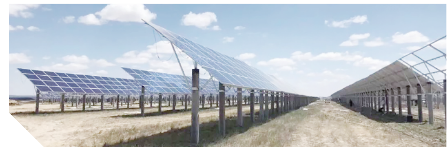
图为位于张家口尚义县的光伏扶贫电站。 资料图片
