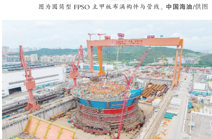
图为圆筒型FPSO主甲板布满构件与管线。中国海油/供图
