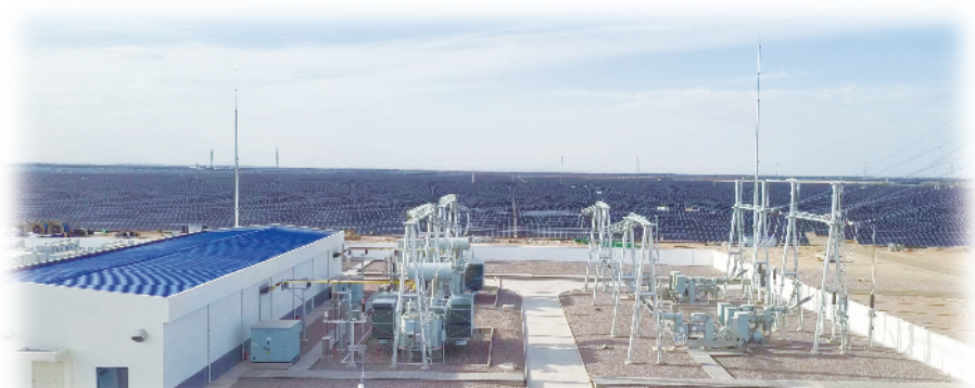
图为金川集团正耀光伏电站。常清树/摄
