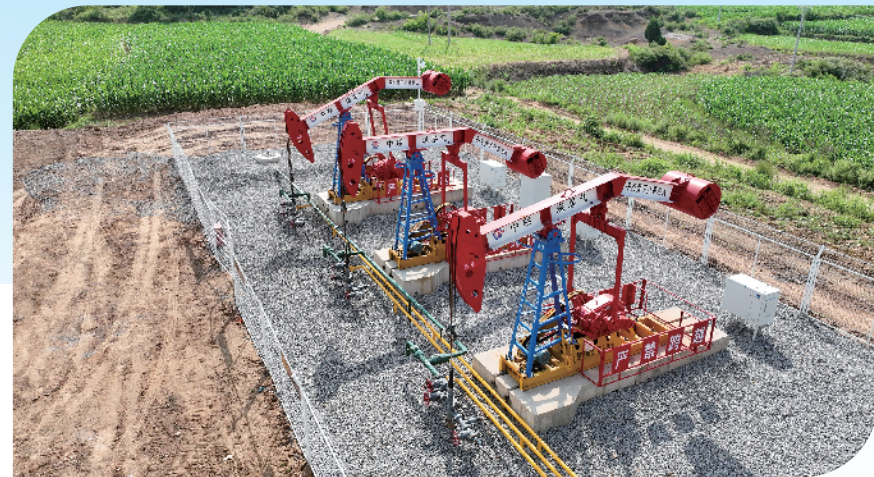
图为潘河区块薄煤层气井排采现场。中国海油/供图
