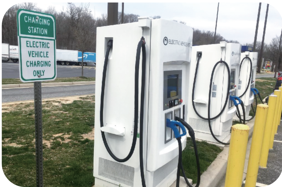
95号州际公路马里兰州段休息站的电动汽车快速充电站。资料图
