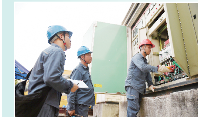
▲供电员工定期对村超现场用电设备进行检查。 陈举/摄
