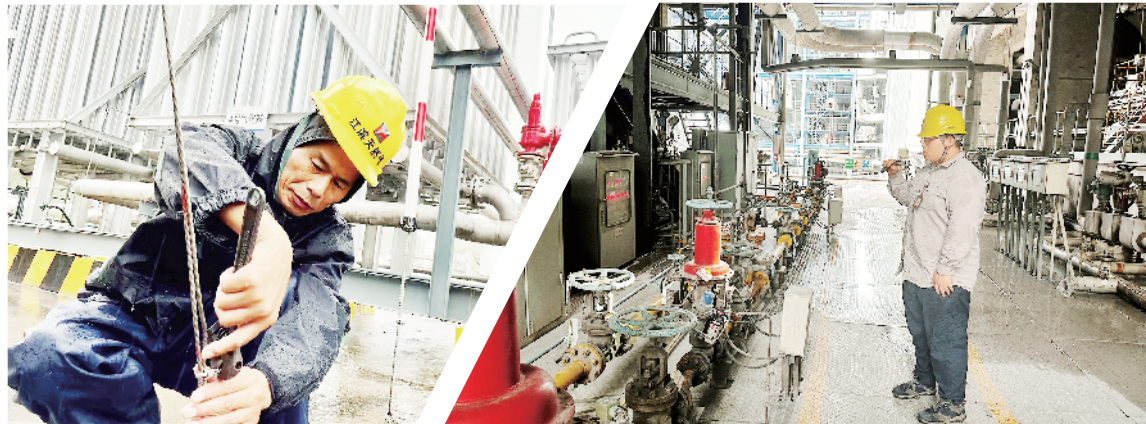
浙能集团所属电站工作人员正在进行设备防风加固。王素素/供图
