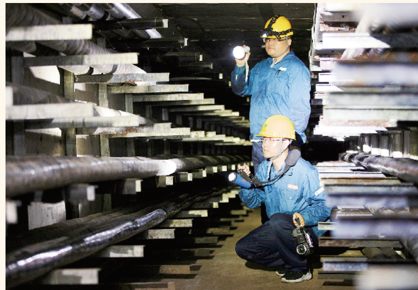
山东潍坊临朐县供电公司变电运维人员冒高温对110千伏临朐站地下电缆通道进行迎峰度夏特巡。 王一珺/摄
