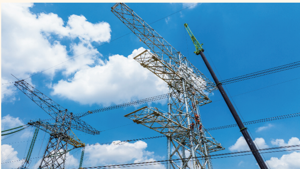
图为南方电网广东广州供电局工作人员正在改造增城区新塘镇电网架空线路。李瀚明/摄
