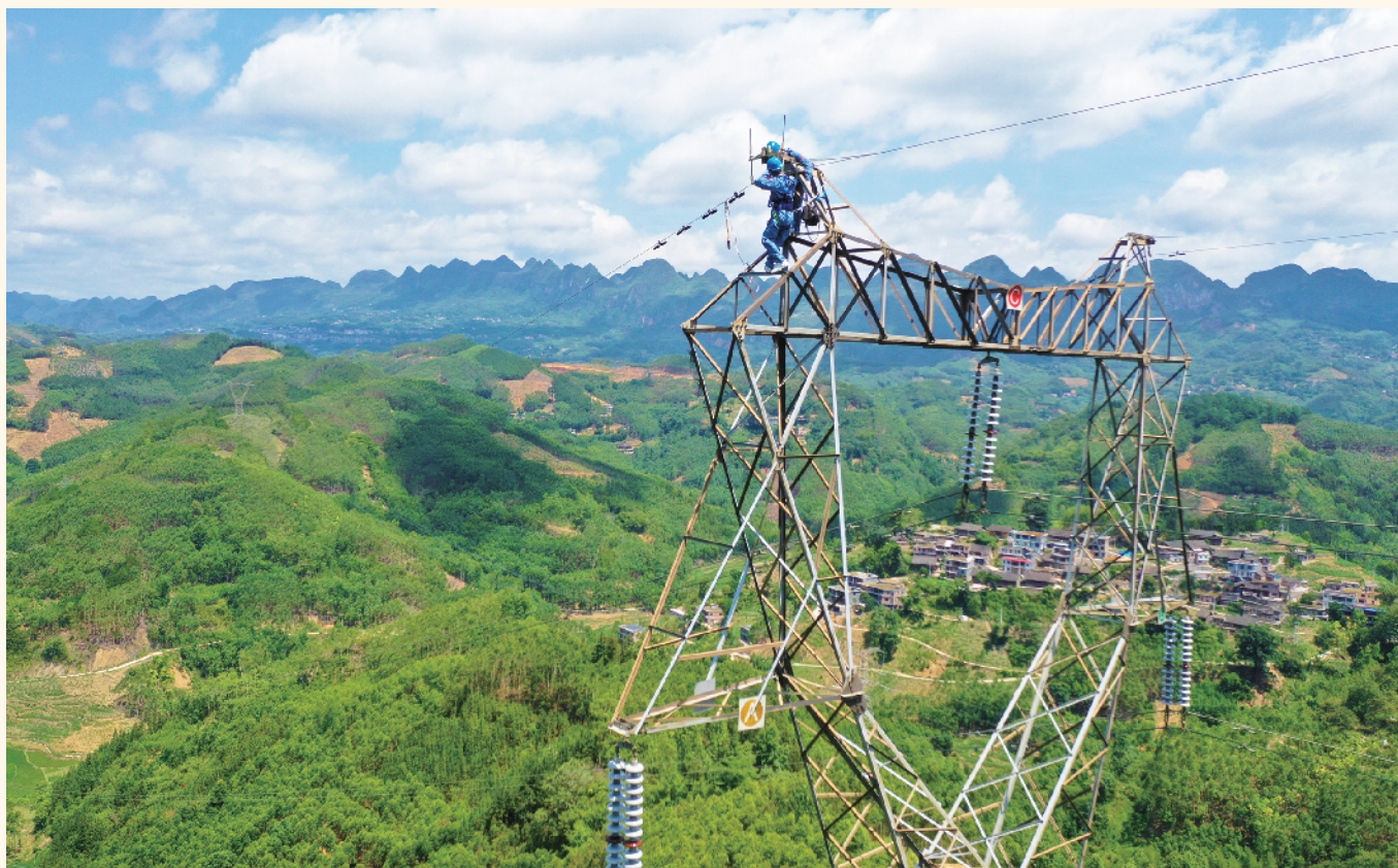
图为南方电网超高压公司曲靖局运维人员在更换220千伏鲁马Ⅱ线98号塔地线线夹,全力确保度夏期间可靠用电。张柯龙/摄
