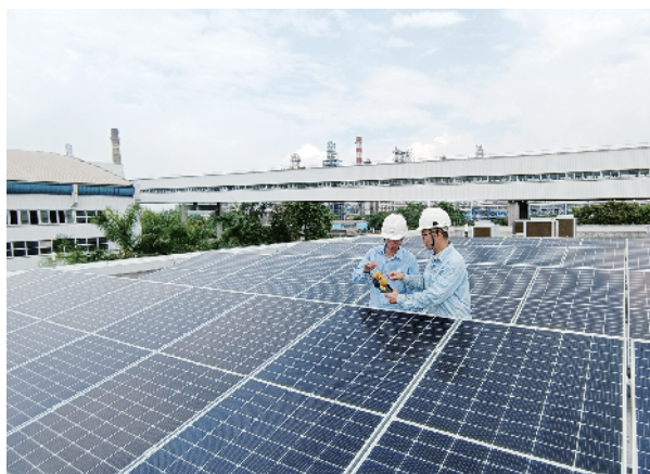
图为炼油中心控制室屋顶的光伏发电项目。
