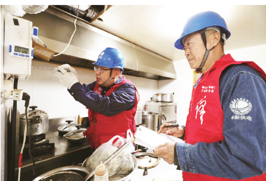
6月12日,国网阜新供电公司电力网格员帮助阜新市海州区西华园小区惠民社区食堂检查用电设备,排除用电隐患。
