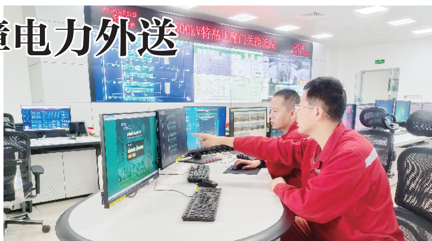
图为国网山西超高压变电公司±800 千伏雁门关换流站运维人员查看“设备运行状态感知及故障智能诊断系统”自动生成的状态曲线，排查设备隐患。 国网山西电力供图
