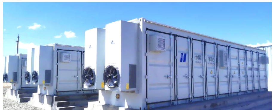
图为华能某储能电站。
