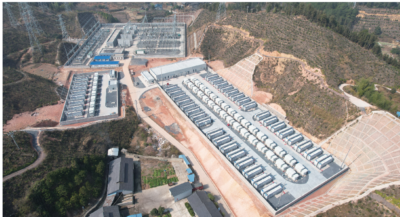
图为投资4.3亿元的百兆瓦级湖南通道塘冲储能电站。视觉中国
