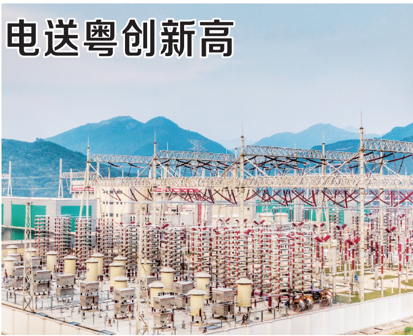
图为航拍闽粤联网工程云霄换流站（广东侧）。李杰杰 陈海东/摄
