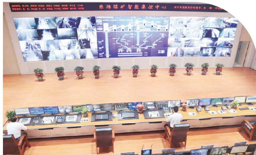
世界一流的兖矿能源东滩煤矿智能集控中心。
